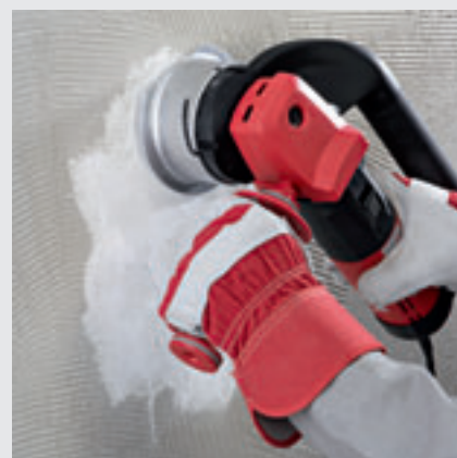
De freeskop met zijn 12 hardmetalen wielen is bijzonder geschikt om oude tegellijm te verwijderen.
