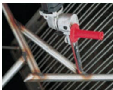
Lasnaden verwijderen, schuren en polijsten op moeilijk bereikbare plaatsen. Zelfs de binnenkant van buizen zijn bereikbaar.
