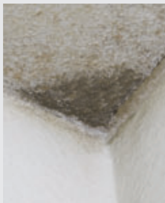
Welke besmetting ook, het kan professioneel verwijderd worden met machines van FLEX - bijv. RETECFLEX.
